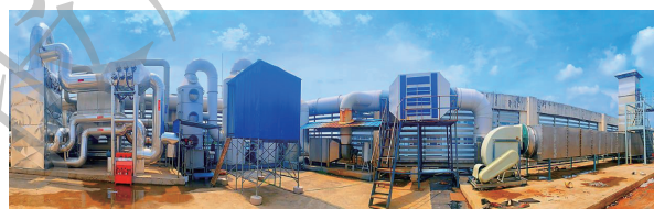
图2 多效热回收催化燃烧工艺净化现场
